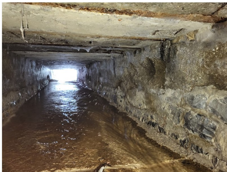
Blick gegen Fliessrichtung, Ausbrüche in Beton, korrodierte Stahlträger in Decke
